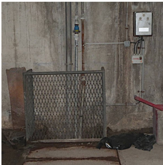
Fosse de relevage
